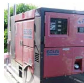
施設裏にある自家発電機
